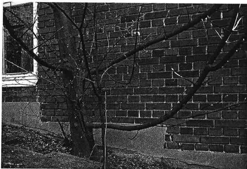
Figur 1. Nærtstående træer har forårsaget revnerne i ydervæggen ved at udtørre fede leraflejringer under funderingsniveau. Lerets volumen er svundet ved udtørringen, hvilket har resulteret i lodrette og vandrette bevægelser af fundamentet.
